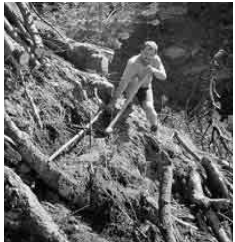
Ausgraben der alten und Verlegen der neuen Wasserleitung war nur eine von vielen Arbeiten im 2003.
